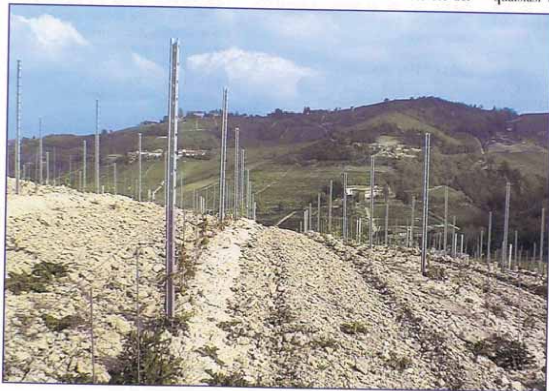
Nuovo impianto con pali di ferro zincato. New plant with zinc-plated iron poles.
